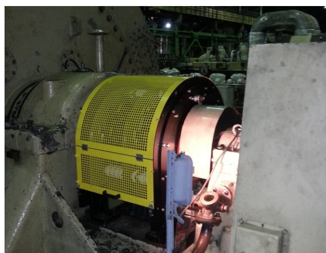
Установленный ЩКА SV1344 R01
