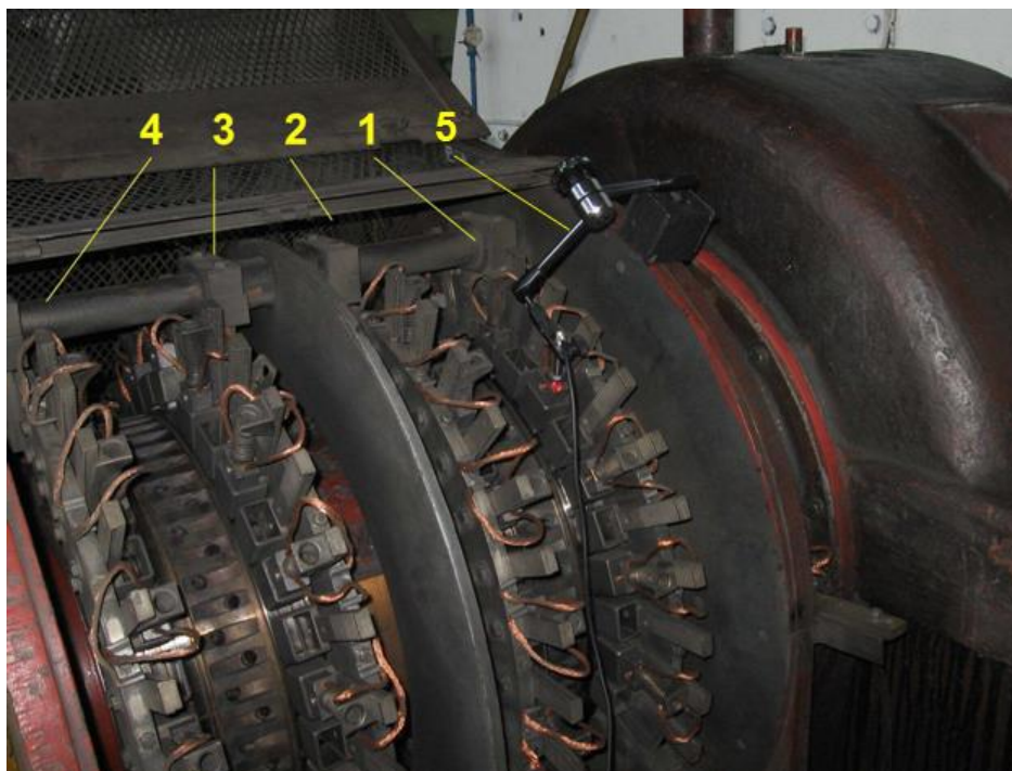
Рис. 5. Проверка биения КК при помощи профилометра «CL-profiler» 1-4 - контактные кольца; 5 - профилометр «CL-profiler».
